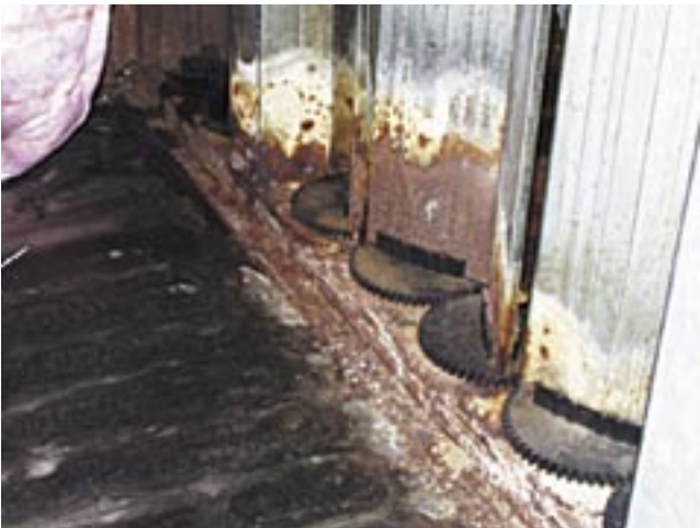
Fig. 54: Bij inspectie bleek de bypassklep van de warmtewisselaar van deze installatie totaal vastgeroest, als gevolg van een waterinfiltratie. Daardoor werd ook in de zomer de toevoerlucht voorverwarmd met afvalwarmte van de luchtafvoer!
