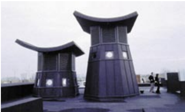
Fig. 38: De ventilatieschouwen van het IVEG-gebouw zorgen voor de afvoer van de intensieve nachtelijke ventilatie. De grote luiken bovenaan worden automatisch geopend wanneer er moet worden gekoeld. Anders worden de roosters hermetisch afgeschermd van de binnenomgeving.
