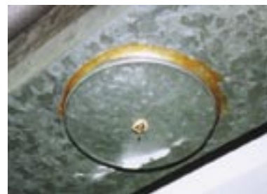
Fig. 57: Oordeelkundig geplaatste en luchtdichte toezichtluiken maken controle op de toestand van luchtkanalen en onderhoud eenvoudig.
