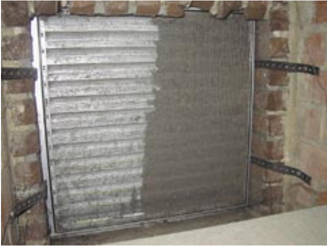
Fig. 53: Een sterk vervuild inlaatrooster, rechts zoals aangetroffen bij een inspectie volgens het Boverket-schema, links na reiniging. Niemand in het gebouw was zich bewust van de graad van vervuiling.
