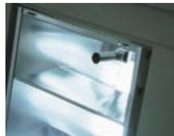
Fig. 66: Een kleine sensor in het verlichtingstoestel meet de luminantie op het werkoppervlak en regelt het vermogen van het kunstlicht naar gelang van het beschikbare daglicht.
